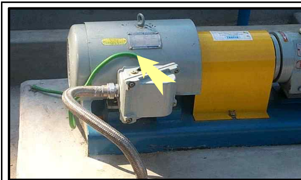
전기기계기구 구동모터 접지 ○
