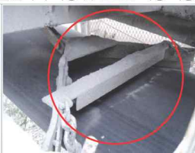
스크레이퍼* 설치 (벨트에 정착된 퇴적물 제거 장치)
