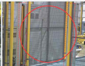
감응형 방호장치(광전자식 등) 설치
