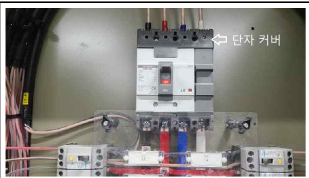
충전부 방호덮개 설치 ○
