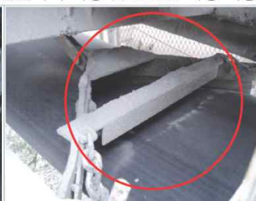
스크레이퍼* 설치 (벨트에 정착된 퇴적물 제거 장치)
