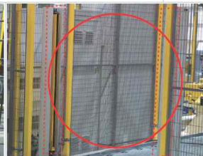
감응형 방호장치(광전자식 등) 설치
