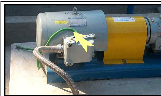
전기기계기구 구동모터 접지 ○
