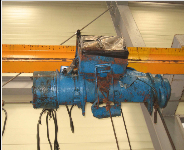
권과방지장치 및 과부하방지장치 등 방호장치 파손 사례
