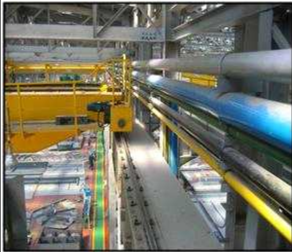
작업구간 레일측면에 미부착
