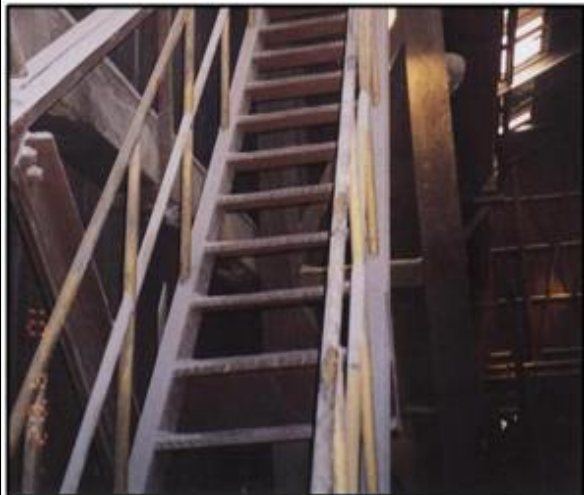
통로 출입구에 잠금장치 미설치
