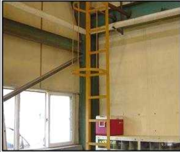
수직사다리 입구에 잠금장치 미설치
